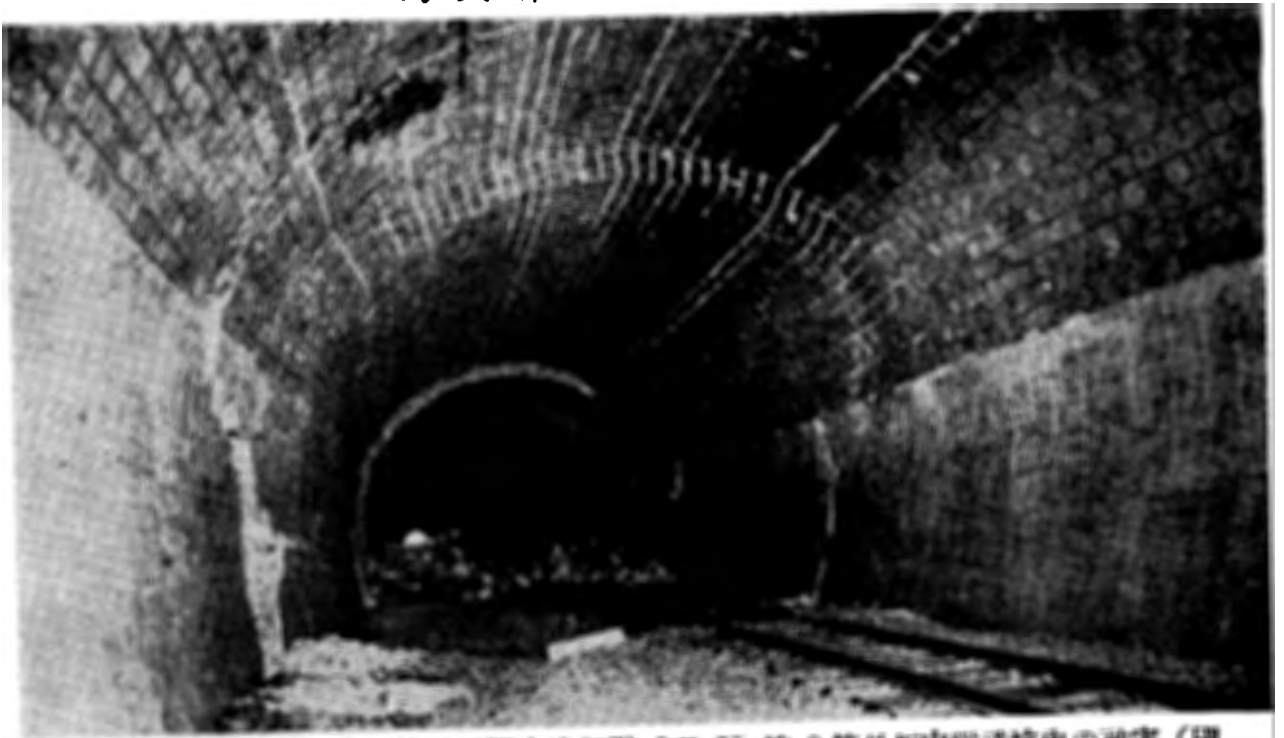
國有鐵道 熱海線根府川真鶴間國府津起點 9哩 55 鎖 0 節長坂山隧道坑内の被害 (國府津方を望む)
